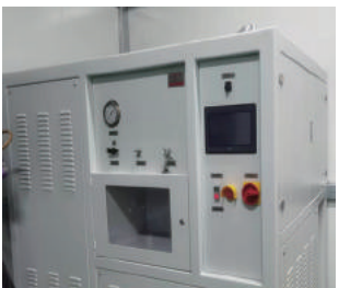
液压冲洗设备
